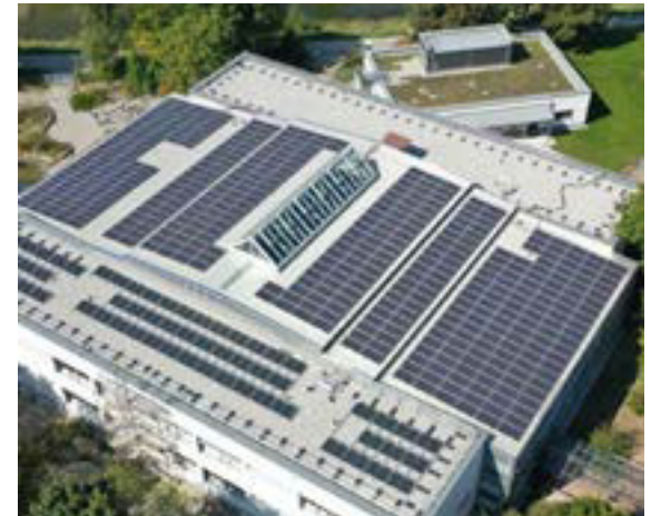
Installation einer 19,77 kWp PV-Anlage auf den Dach der Grundschule „An der Ammer“
